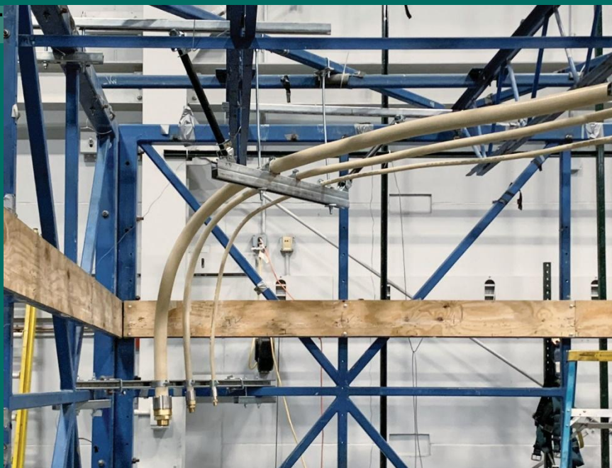
Système de tuyaux médicaux MediTrac® CMT sur un banc d'essai sismique.
