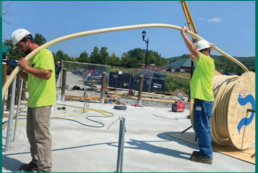
Conduite d'oxygène principale en souterrain pour un centre médical.
